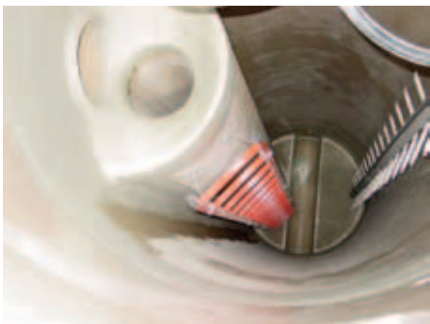
Фото 4-5-1 Смотровый колодец с внутренним задником
